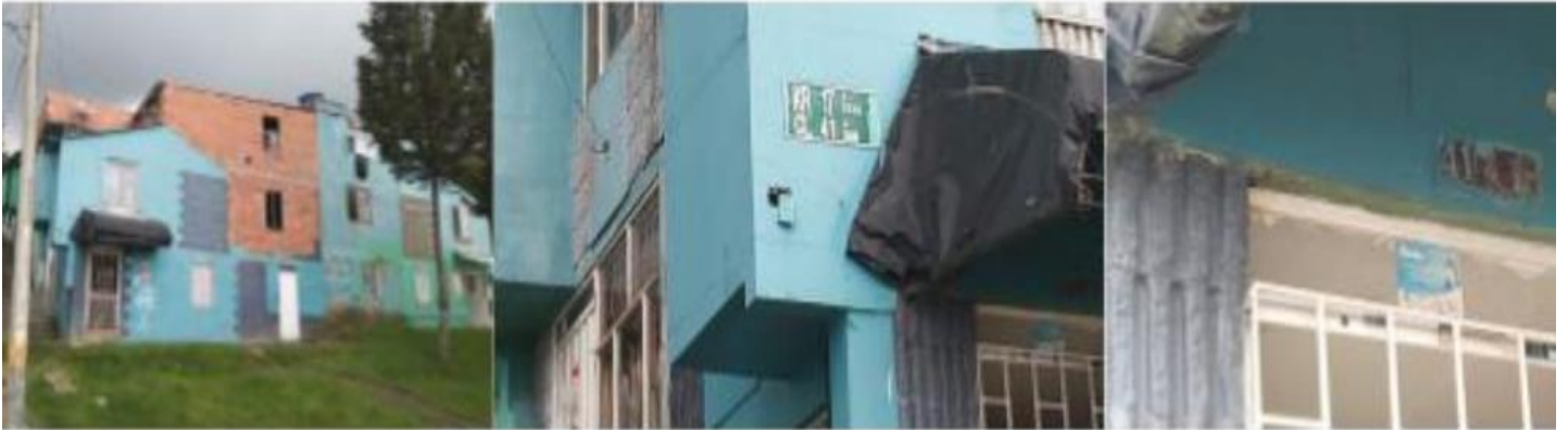
IMAGEN 10: CALLE 41 A SUR No 17 – 08 ESTE, DETERIORO, CAMBIO DE FACHADAS
