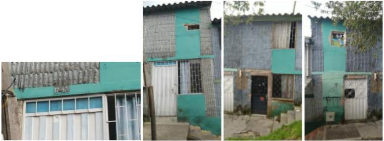
IMAGEN 13: CALLE 41 A SUR No 17 – 85 E- DETERIORO
