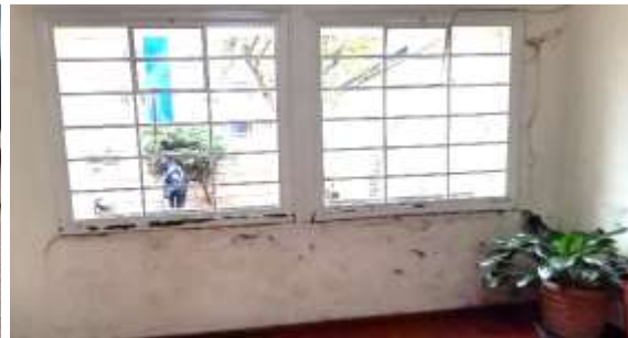
Fotografía 4. Muros con problemas estructurales y de humedad
